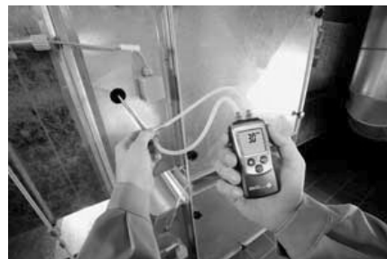
ပုံ ၅-၂၂ Duct test hole မှ တစ်ဆင့် air flow တိုင်းယူပုံ
