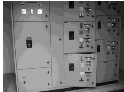
ပုံ ၁၃-၅၁ Electrical panel
