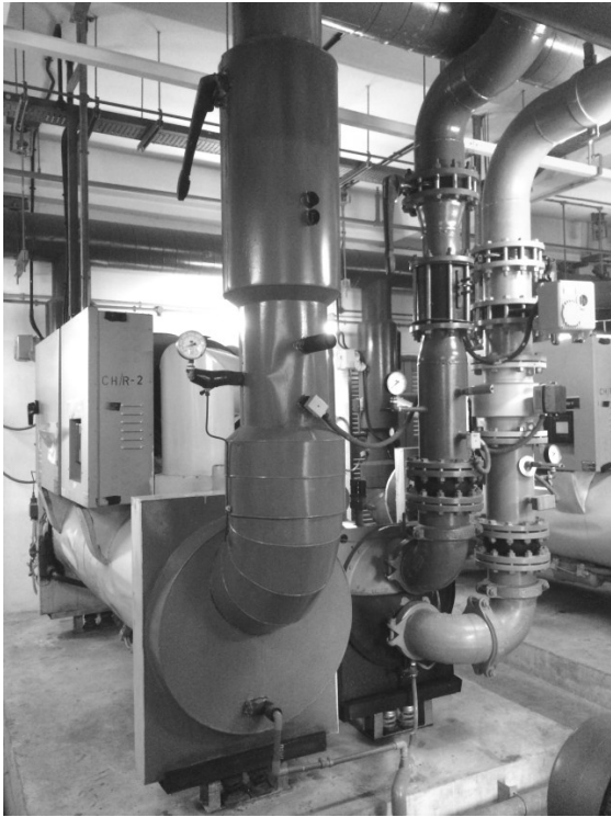
ပုံ ၆-၁၀ Chiller pipe connection
