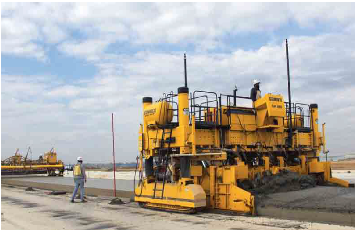
ပုံ(1.13) GHP 2800 Slipform Concrete Paver အသုံးပြုပြီး လေယာဉ်ကွင်း ဆောက်နေပုံ
