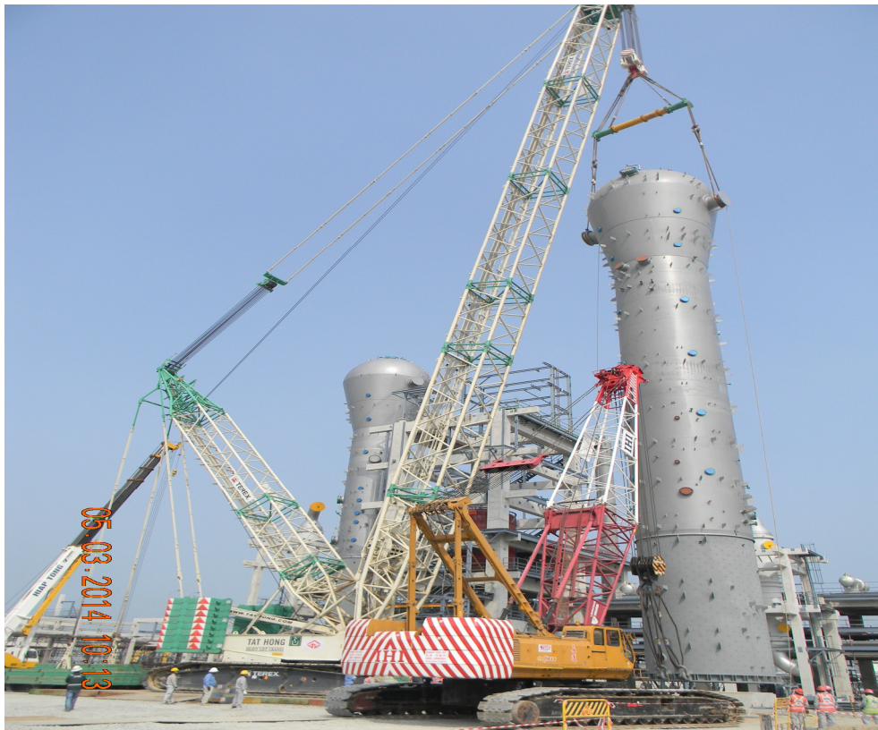
Vertical ထောင်ပြီးရင် Tailing Crane က ကြိုးတွေ ဖြတ်ပြီး Install လုပ်မည့်နေရာကို လှည့်သွားရပါသည်။
